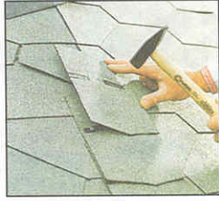
Выкроенные из полос половинки кладут также снизу вверх, подгоняют к форме крыши и крепят гвоздями, забивая их в верхние части элементов.
